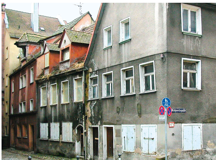
Die Handwerkerhäuser Kühnertsgasse 18-22 vor der Sanierung © Uwe Kabelitz
